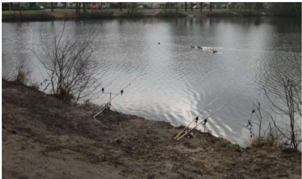
Op verschillende plekken is de oever aan het afkalven
